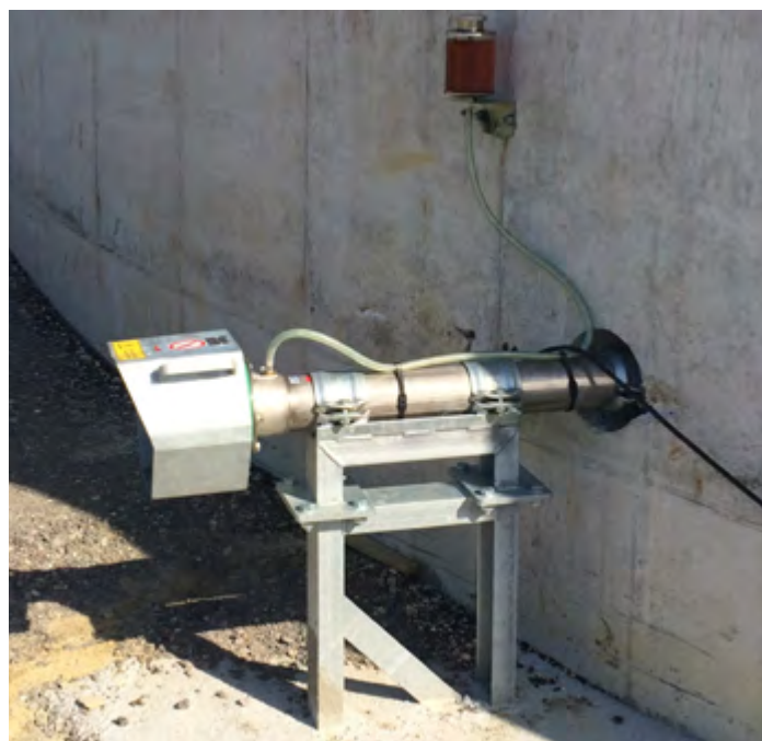
FR HY stacjonarny - zbiornik betonowy
