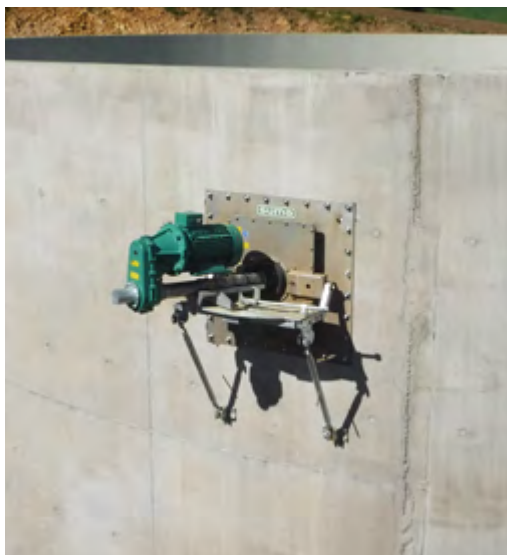
FR SP – zbiornik betonowy
