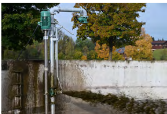
PRESSURA LW – zbiornik betonowy
