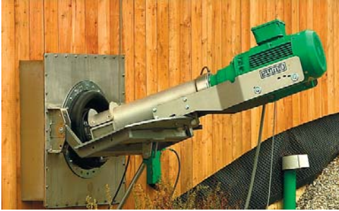
Rührgigant AMT an der Behälterwand
