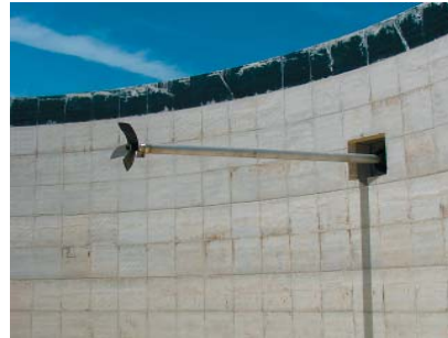
Rührgigant AMT im Behälter
